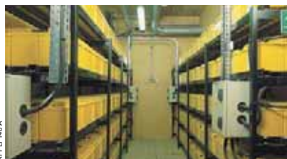
APPL 146 A Применение в аккумуляторной комнате.
