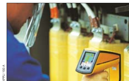
Контроль состояния трансформаторов
